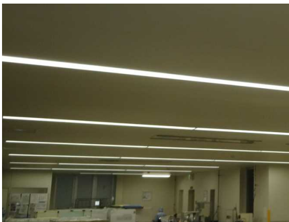
製造棟包装室照明のLED化
